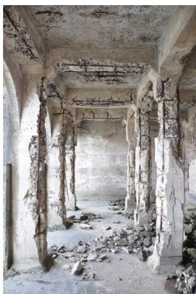
写真-4 柱梁の劣化状況
