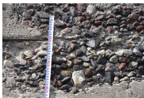
写真-6 下流側面の骨材露出
