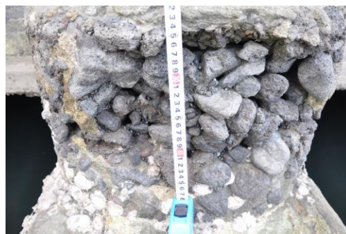
写真-5 堰柱水切りの骨材露出
